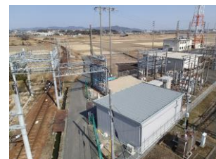
渥美線 植田変電所更新
